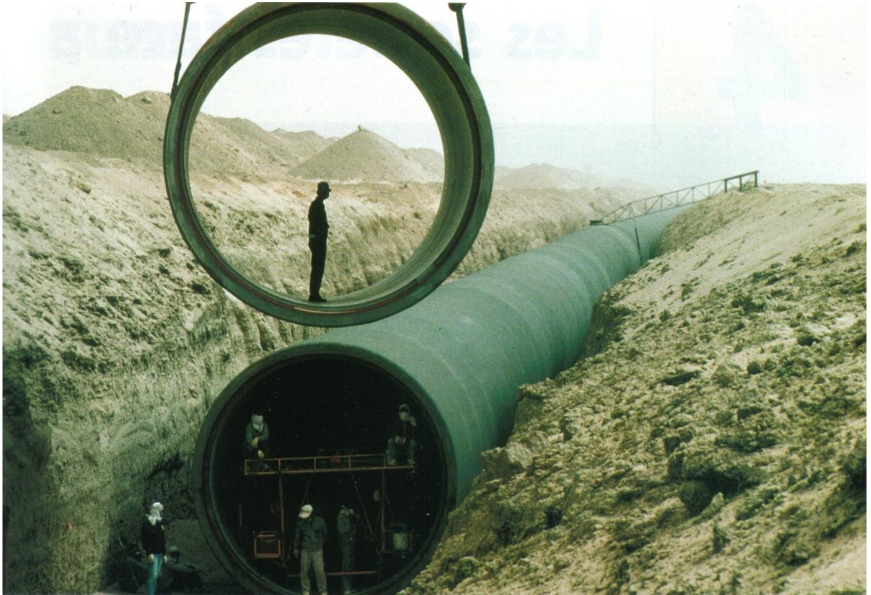
Pose de canalisations de la Grande Rivière Artificielle, Libye, fin des années 1990 Les eaux pompées dans les aquifères parcourent jusqu'à 3 500 km avant d'atteindre le littoral.
